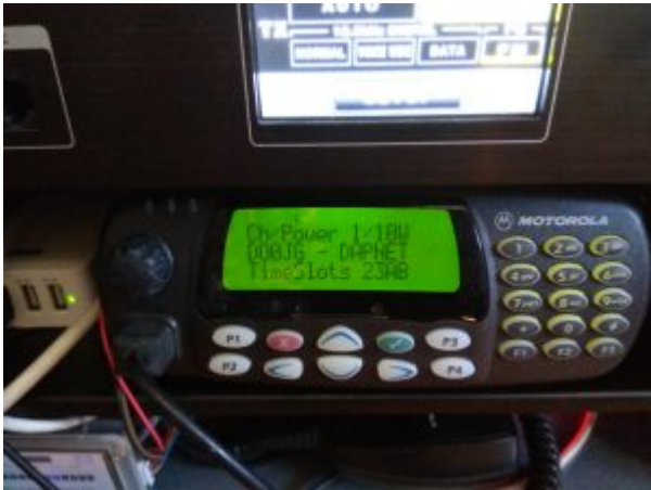
aktuell ist ein Motorola GM380 verbaut
